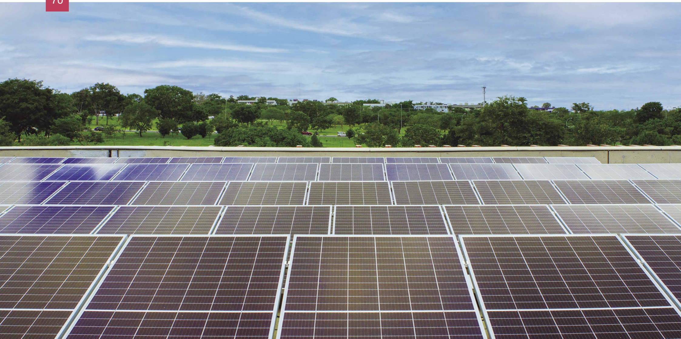
Usina fotovoltaica instalada na cobertura da Sede da FHE POUPEX: fornecimento de energia limpa
