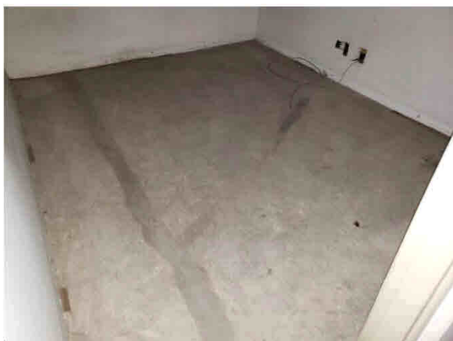
Foto 15 – Acabamento do piso e rodapé foi retirado
