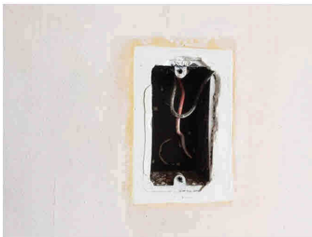
Foto 12 – Detalhe para instalações elétricas incompletas
