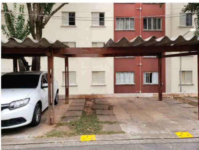
Foto 3 – Vaga de garagem – parcialmente sem telhas
