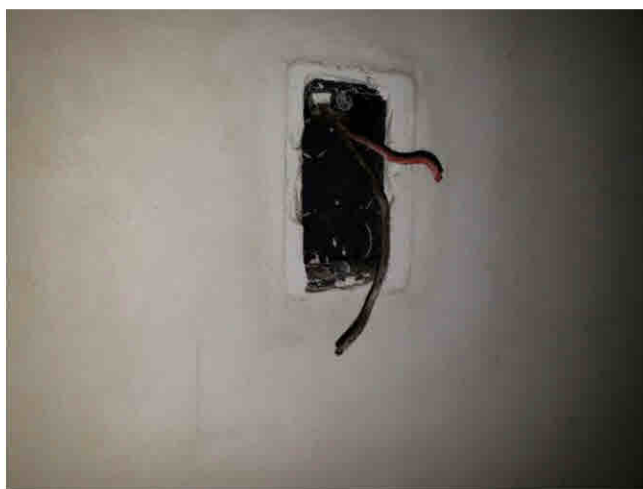
Foto 18 – Detalhe para instalações elétricas incompletas
