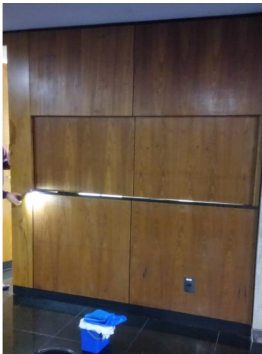
Imagem 06 – Painel em lâmina de madeira freijó a serem substituídos.
