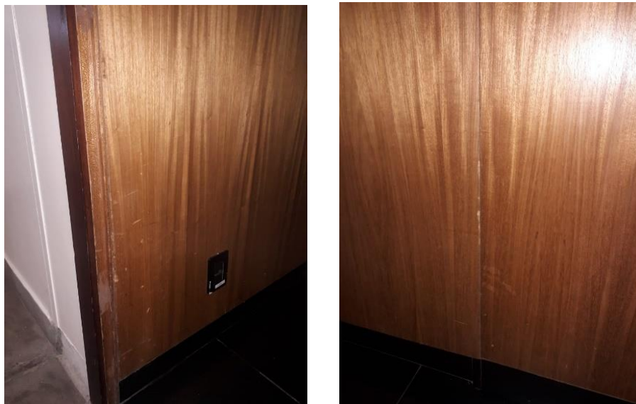
Imagem 03 – Painel 1 encontra-se com riscos e o painel 2 com canto lascado, ao lado da porta.
