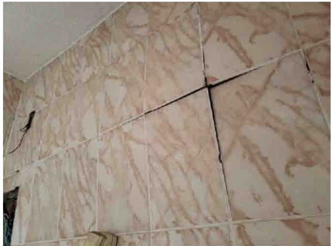
Foto 14 – Revestimento cerâmico da parede da cozinha estufado e descolado
