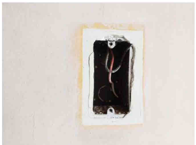
Foto 12 – Detalhe para instalações elétricas incompletas
