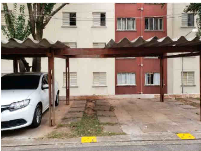
Foto 3 – Vaga de garagem – parcialmente sem telhas
