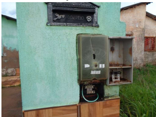
Foto do padrão e medidor de energia - danificado
