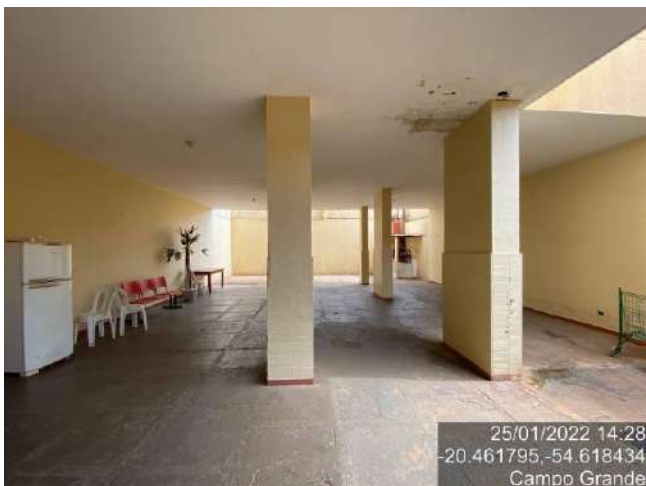
Foto 5 – espaço de lazer comum, infiltração em forro
