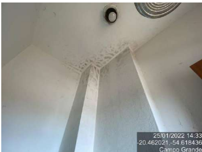
Foto 13 – mofo no teto do banheiro de serviço
