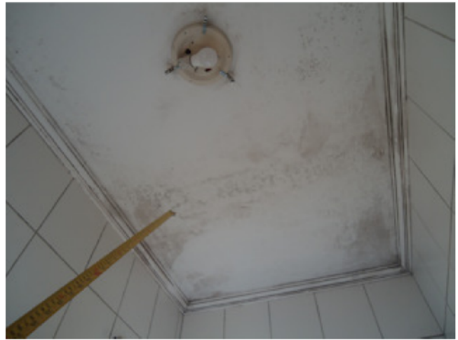
Foto 8 – Vista da umidade teto banheiro suite
