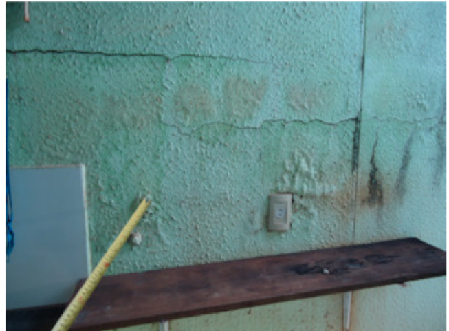
Foto 12 – Vista das fissuras e unidade próximo tanque
