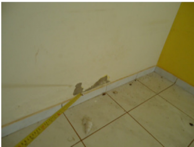
Foto 9 – Vista da umidade suite
