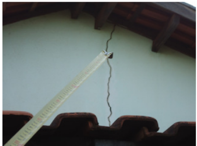
Foto 10 – Vista da rachadura oitão fundo
