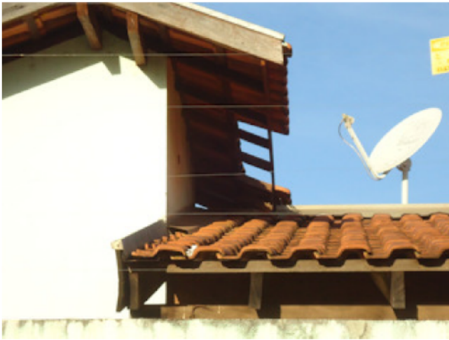
Foto 7 – Vista falta telhas do beiral frontal
